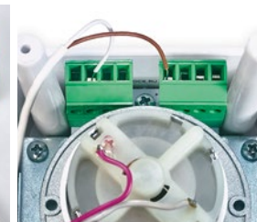
Фото 11. Подключение датчика к электроприводу
