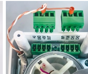
Фото 18. Подключение проводного выключателя к электроприводу
